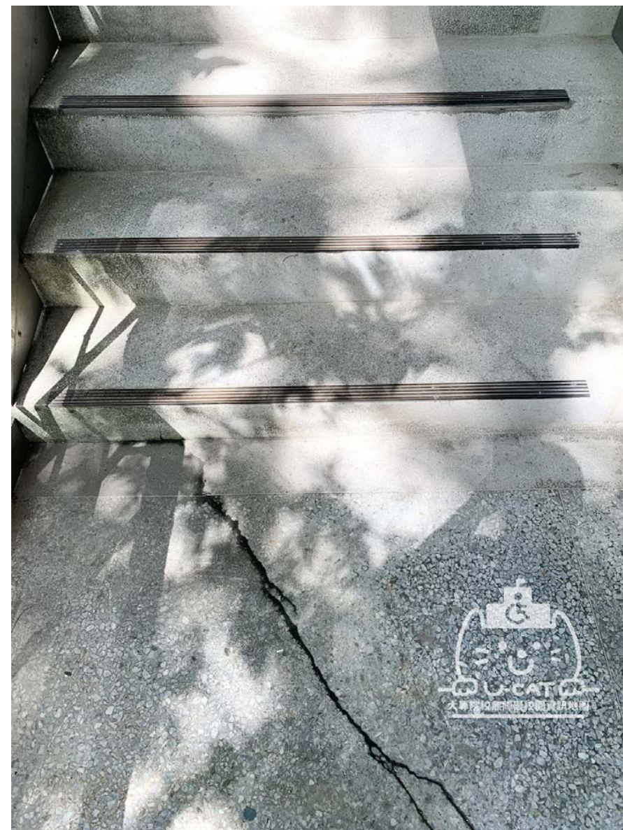
樓梯平台龜裂
