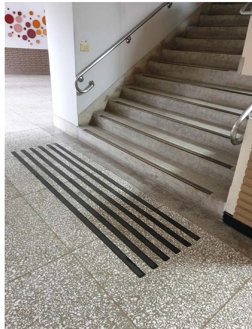
金鋼砂終端警示
